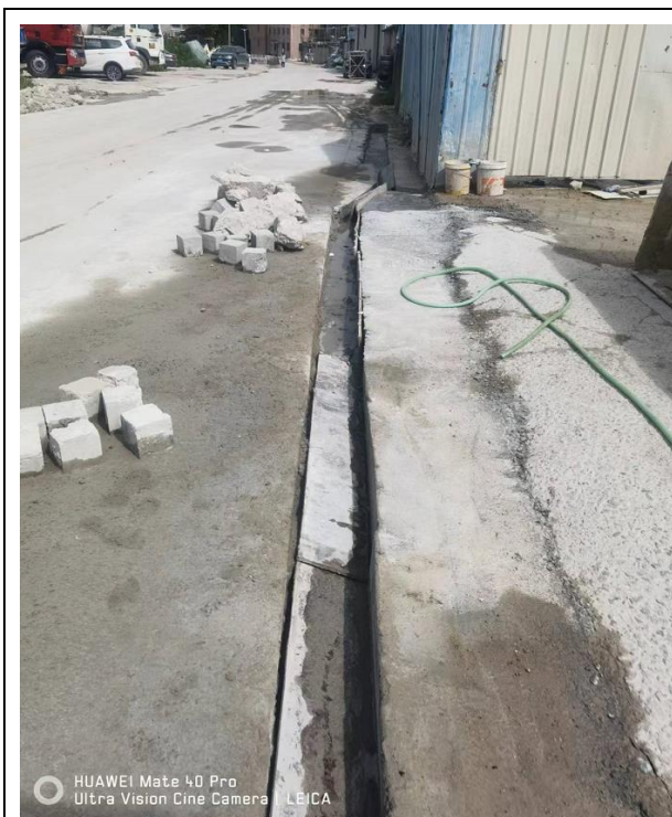
生产废水收集沟
