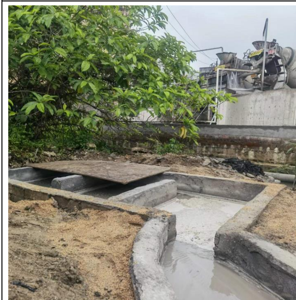
生产废水沉淀水池（兼事故应急池）
