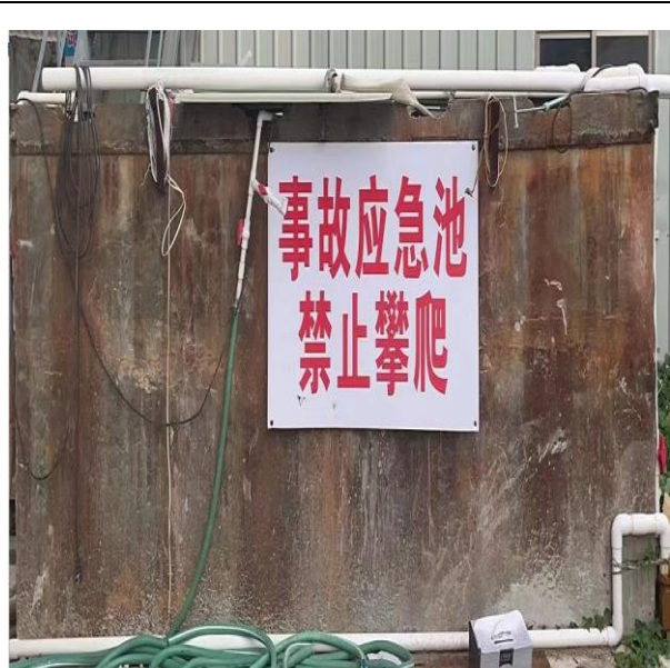
初期雨水储存池（兼事故应急池）
