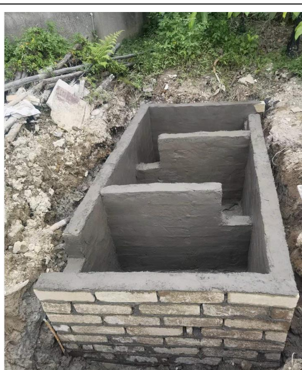
生产废水沉淀水池
