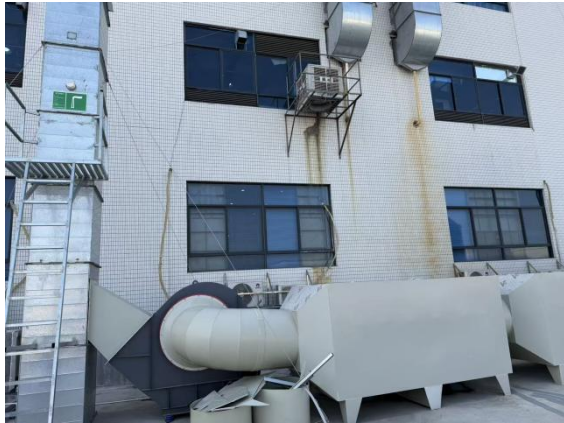
水喷淋+两级活性炭吸附设备
